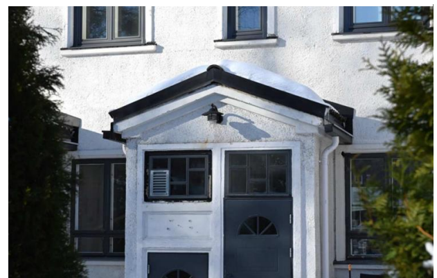
Kuva 46. Sileäpintaisia yksityiskohtia roiske-rappauksen rinnalla. Ovet on vaihdettu tehdasvalmisteisiin standardioviin. (Kuva: T. Ahola, 2023.)
