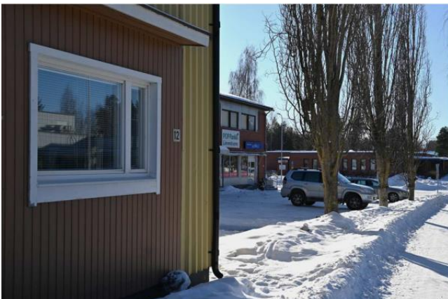
Kuva 55. Aunuksen talon käyttötarkoituksen muutokset ovat vaikuttaneet julkisivuihin. Muun muassa entisten liiketilojen näyteikkunat on pienennetty katu-fasadista. (T. Ahola, 2023.)
