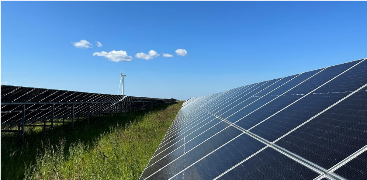
Maa-asenteinen aurinkopaneeliteline Oulun Vihreäsaassa
