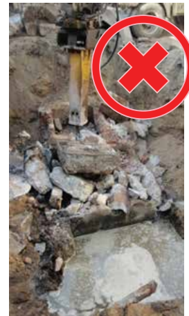
Kuva 8. Vanhat betonijätteen täyttöpaikat tulee siivota ja selvittää.
