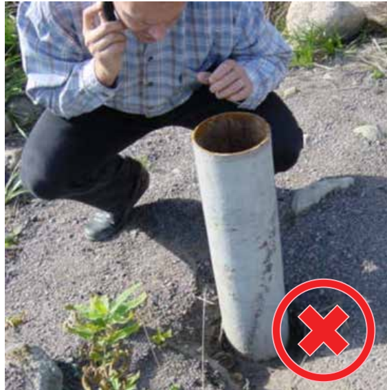
Kuva 4. Putkesta puuttuu sisäputki, hattu ja lukko, ja se on suojattava välittömästi. Tällainen putki ei sovellu tarkkailuputkeksi.
