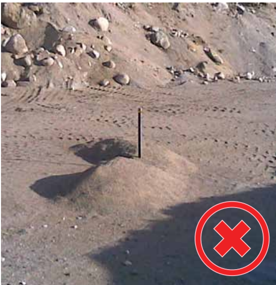
Kuva 3. Putki tulee suojata näkyvästi. Ota huomioon pohjavesiputket toiminnassa, äläkä vahingoita niitä.
